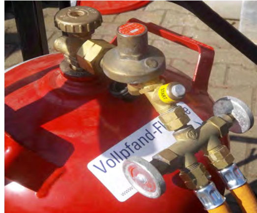
Abb. 4: Gasarmaturen: Flaschenventil, Druckminderer, Schlauchbruchsicherung Verteiler mit Absperrventilen
